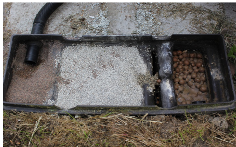
Зураг 14. Био нойл шингэнийг шүүгч филтэр
